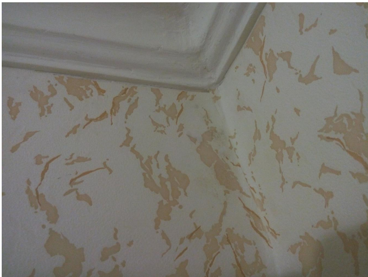
Рис. 6. Очаг грибкового поражения угловой части стены здания
