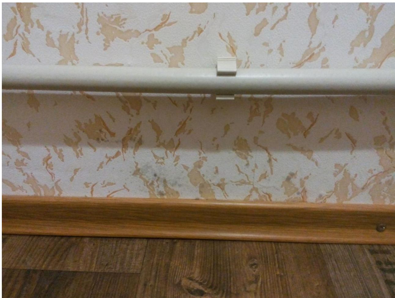
Рис. 5. Очаг грибкового поражения стены здания на уровне пола
